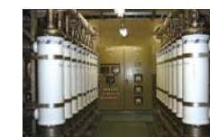
⑱ 浄水ろ過・排水処理 ●逆浸透膜・限外ろ過膜
