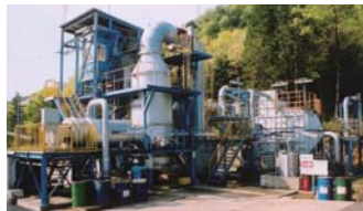
回収インフレーター作業処理設備
